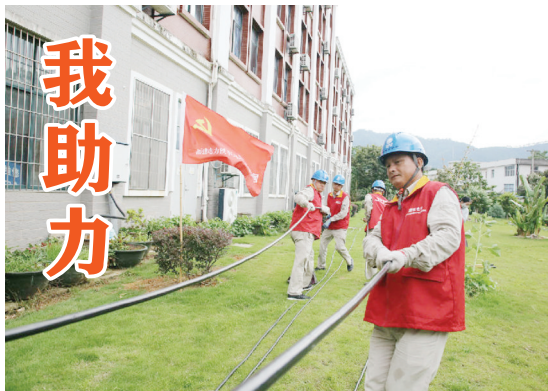
6月4日,国网华安供电公司派出应急发电车、发电机等供电保障设备进驻华安一中高考考点,确保考试期间用电安全。 黄建和 邹惠燕 摄
