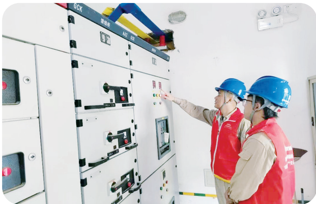
工作人员到南靖一中开展用电检查
